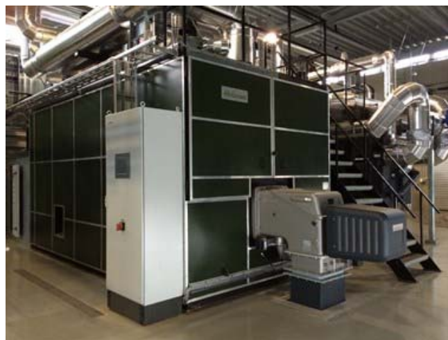
图 12 Voens 大型太阳能热厂锅炉房
