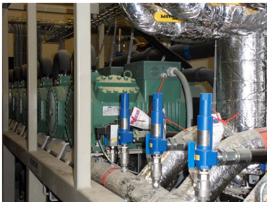
图 5 Marstal 大型太阳能热厂 CO2 热泵机组
