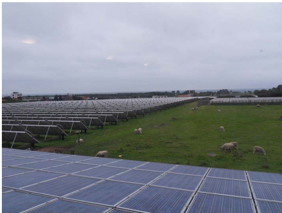
图 4 Marstal 大型太阳能区域供热系统集热器阵列
