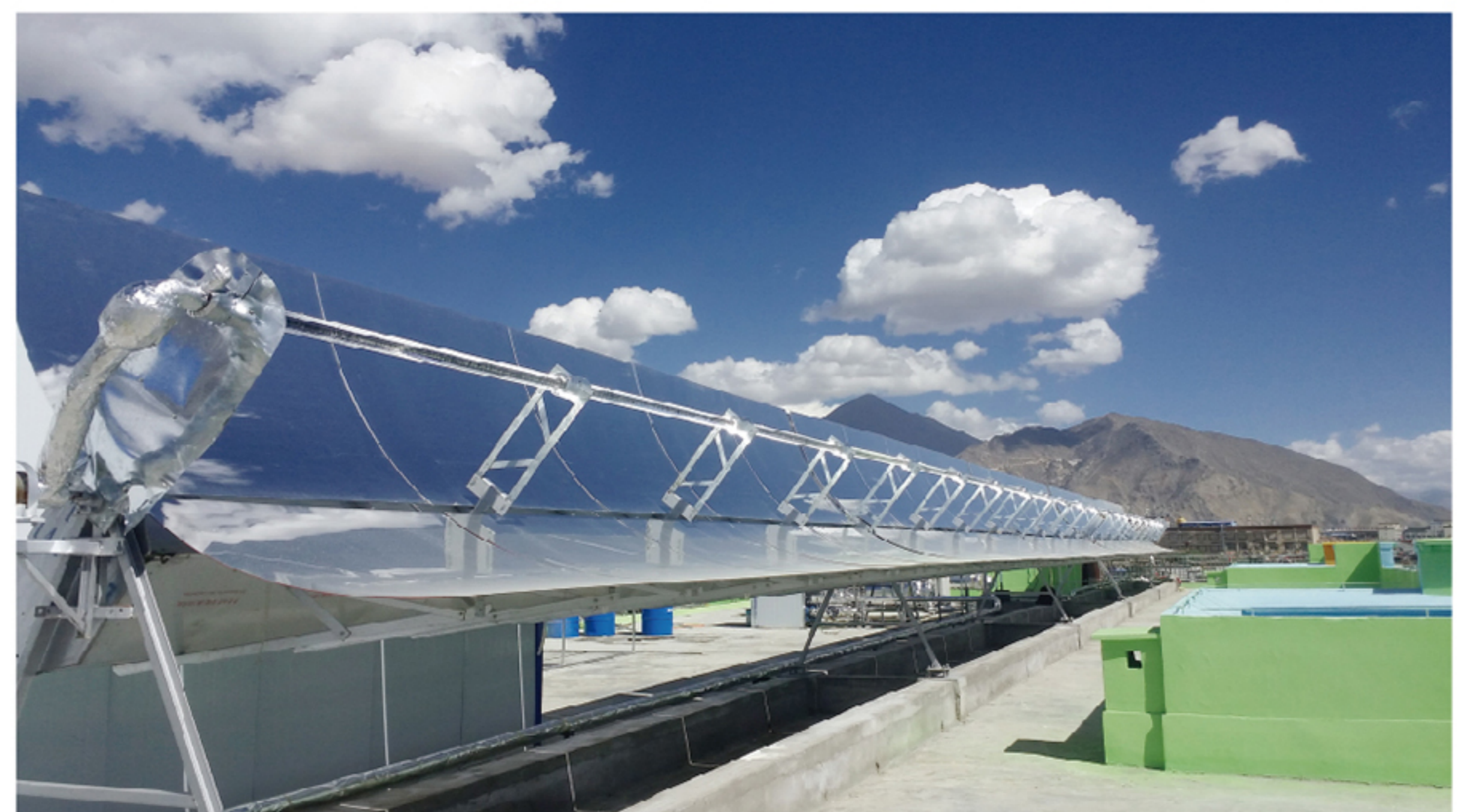
● 西藏拉萨第十五幼儿园太阳能供暖项目 Solar thermal heating project for the No.15 kindergarten in Lhasa, Tibet
