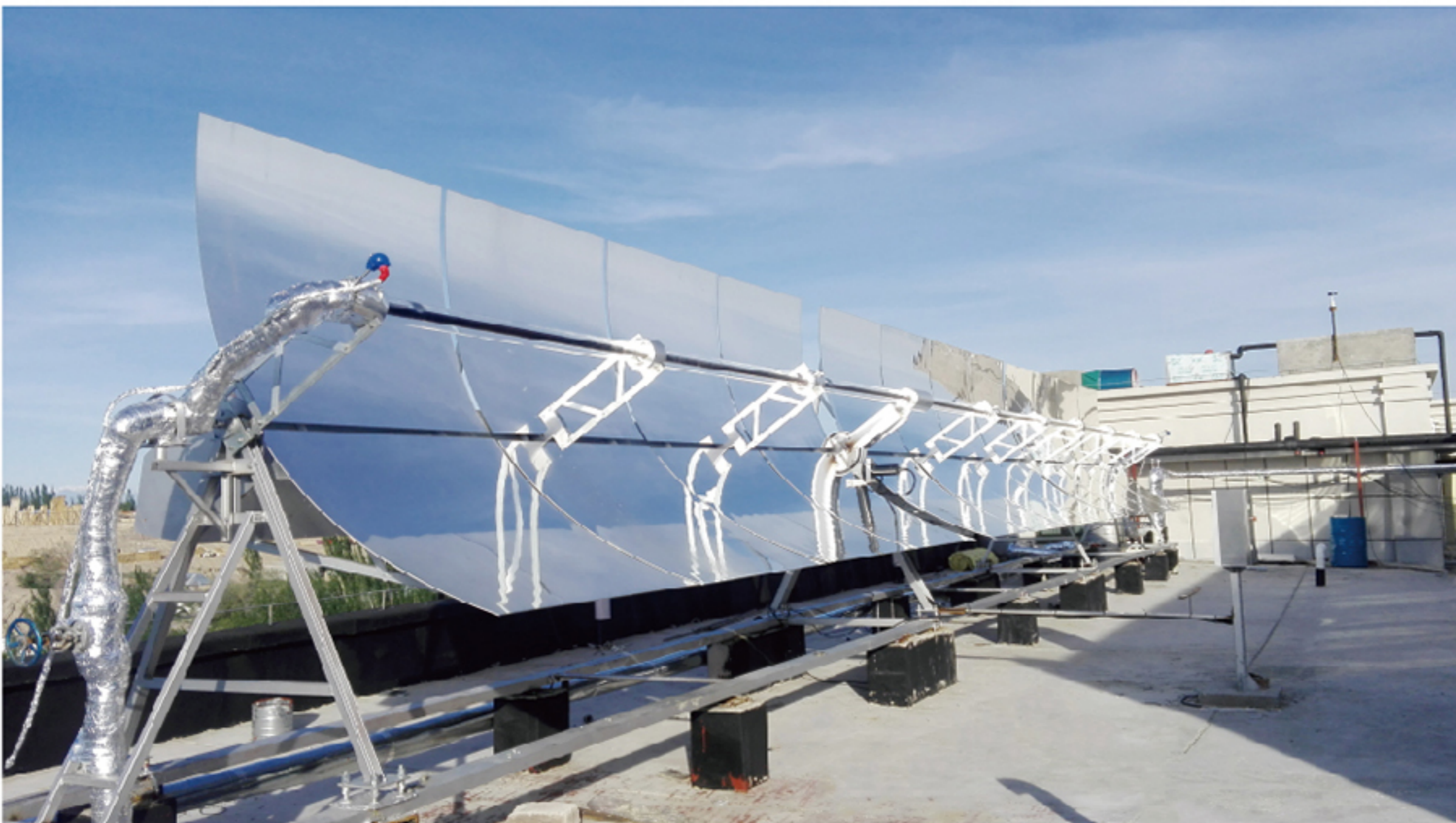
● 新疆伊宁抗病毒中心太阳能供暖项目 Solar thermal heating project for the Yining Anti-viral Center in Xinjiang
