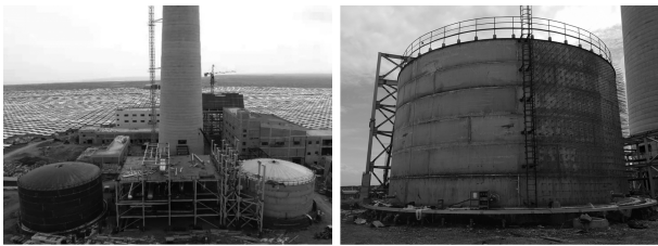
(a) 熔盐储热系统 (b) 高温熔盐储罐
